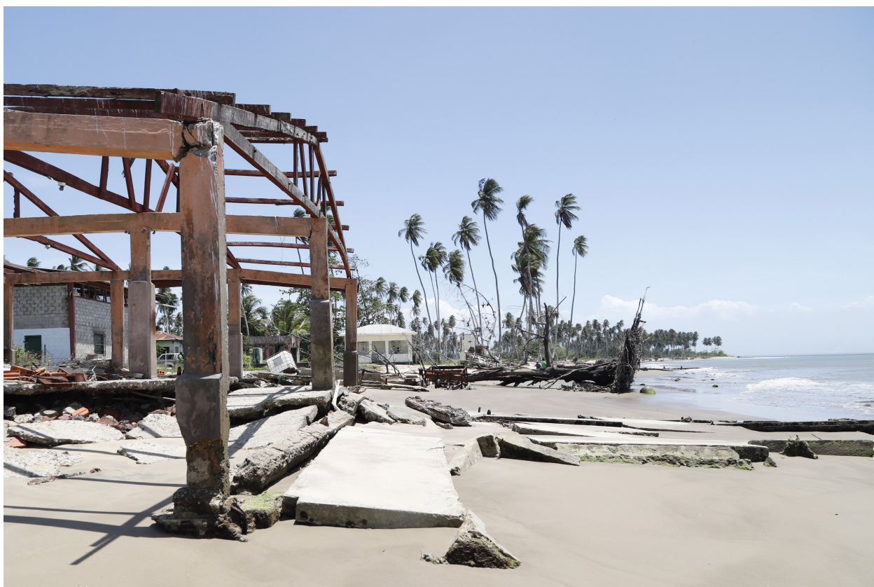
Figura 13 Desplazamiento hacia tierra del escarpe activo como evidencia clara de la tendencia erosiva de una playa. Granville, Cedros, Trinidad.
