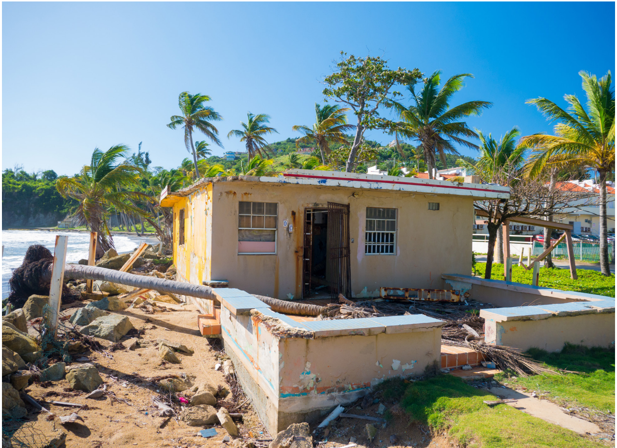
Figura 16 Erosión catastrófica y daños a las infraestructuras en Puerto Rico a causa del huracán María
